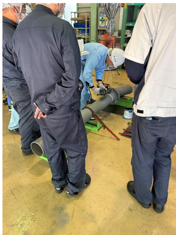
【接合実習 異形管受口と直管挿し口】 異形管の接合（T頭ボルト・ナットの締め付け）
